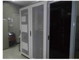
サーバ室：区の庁内基幹ネットワークを構成する主要拠点の一つであり、移設が困難である。
