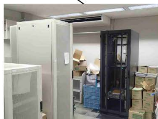
サーバ室：図書館情報システムのサーバが設置されている。
